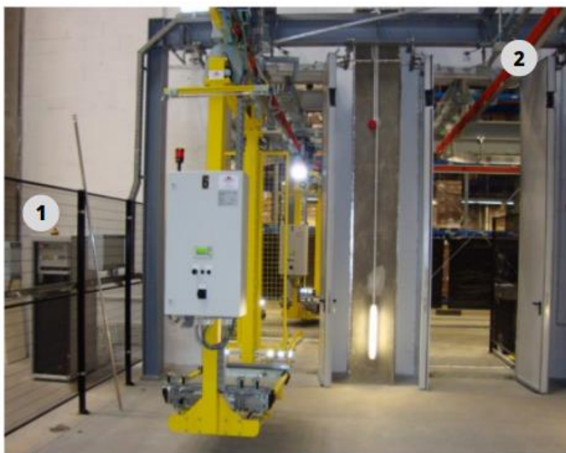
Fot. 3. System transportu podwieszony z przeciwpożarowymi bramami rozwieranymi Marc-D EI 120.
