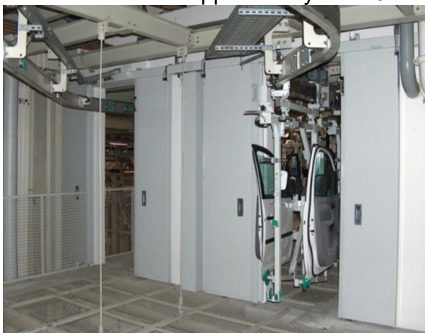
Fot. 7 Dwie bramy rozsuwane Marc-O EI 60 z wycięciami na szynoprzewody transportu podwieszonego.
