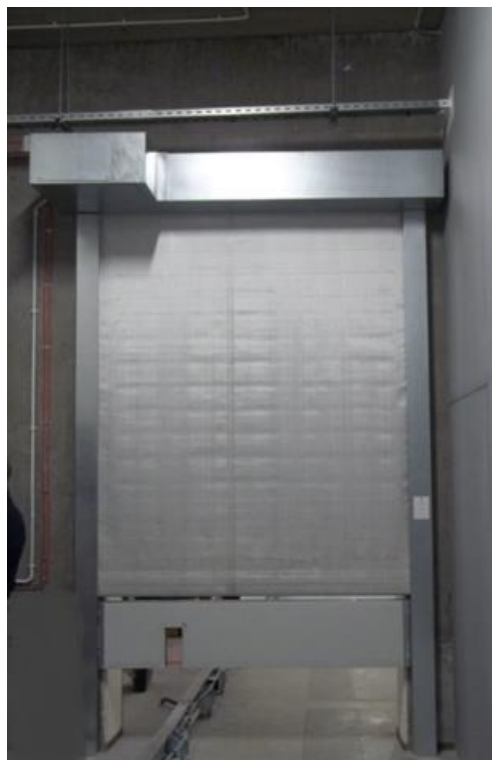
Fot.8. Brama kurtynowa MARC-Ok EI 60 z podwieszonym wyciętym na szynoprzewód sztywnym panelem EI 60.
