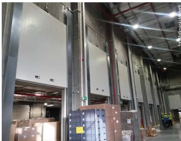
Fot. 2. Bramy opuszczane
