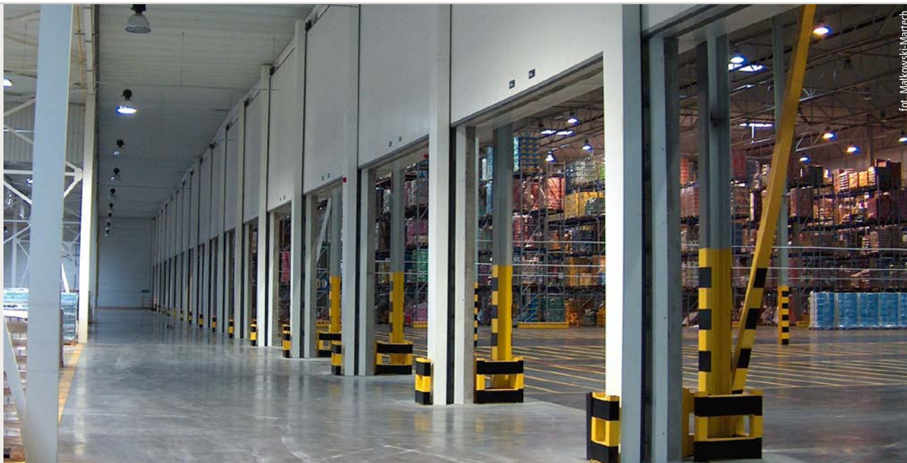
Fot. 4. Bramy opuszczane
