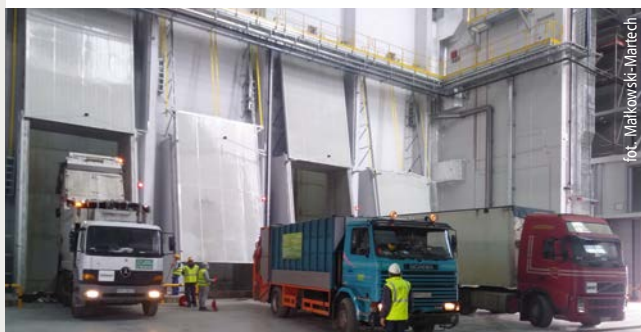
Fot. 6. Bramy opuszczane EI-120 o ruchu skośnym, zamykające wyspy do bunkra odpadów, zainstalowane w spalarni
